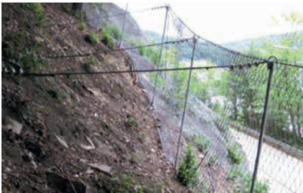
Steinschlagzaun an der Sapplwand
